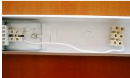
Resim 4.17: Balasta faz kablosunun bağlantısı
