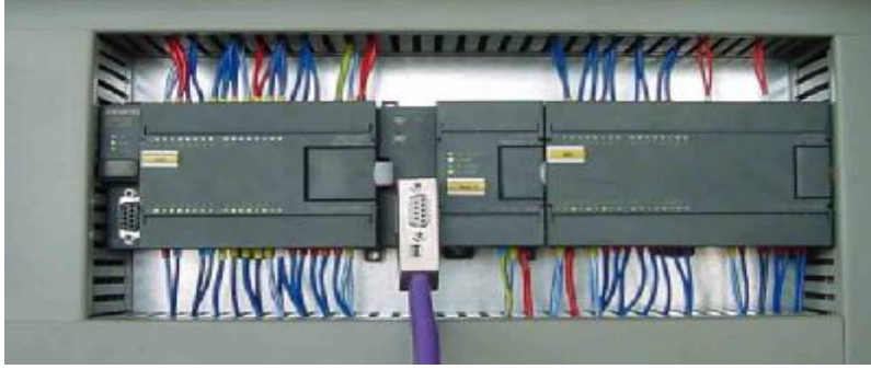
Resim 1.11: Bir PLC'nin pano içerisindeki i
