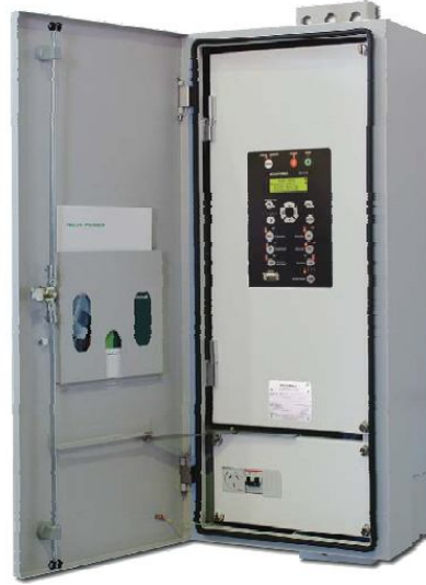
Autorecloser Kontrol Ünitesi
