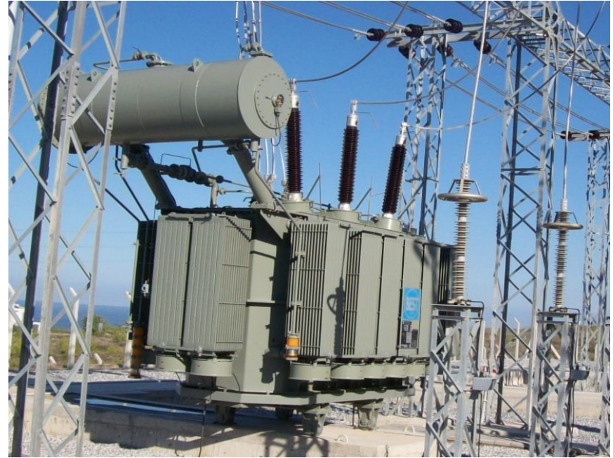
Yeni 132kV-22kV Güç Trafosu
