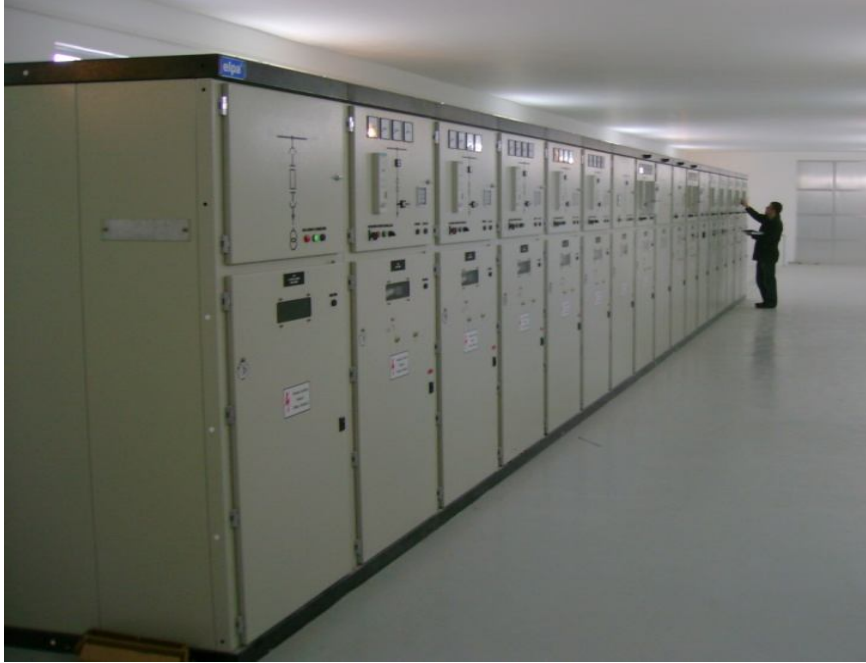
Yeni 22kV OG Kesiciler
