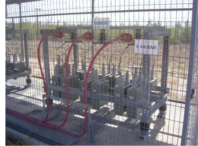
Trafo Merkezlerindeki Kapasitörler
